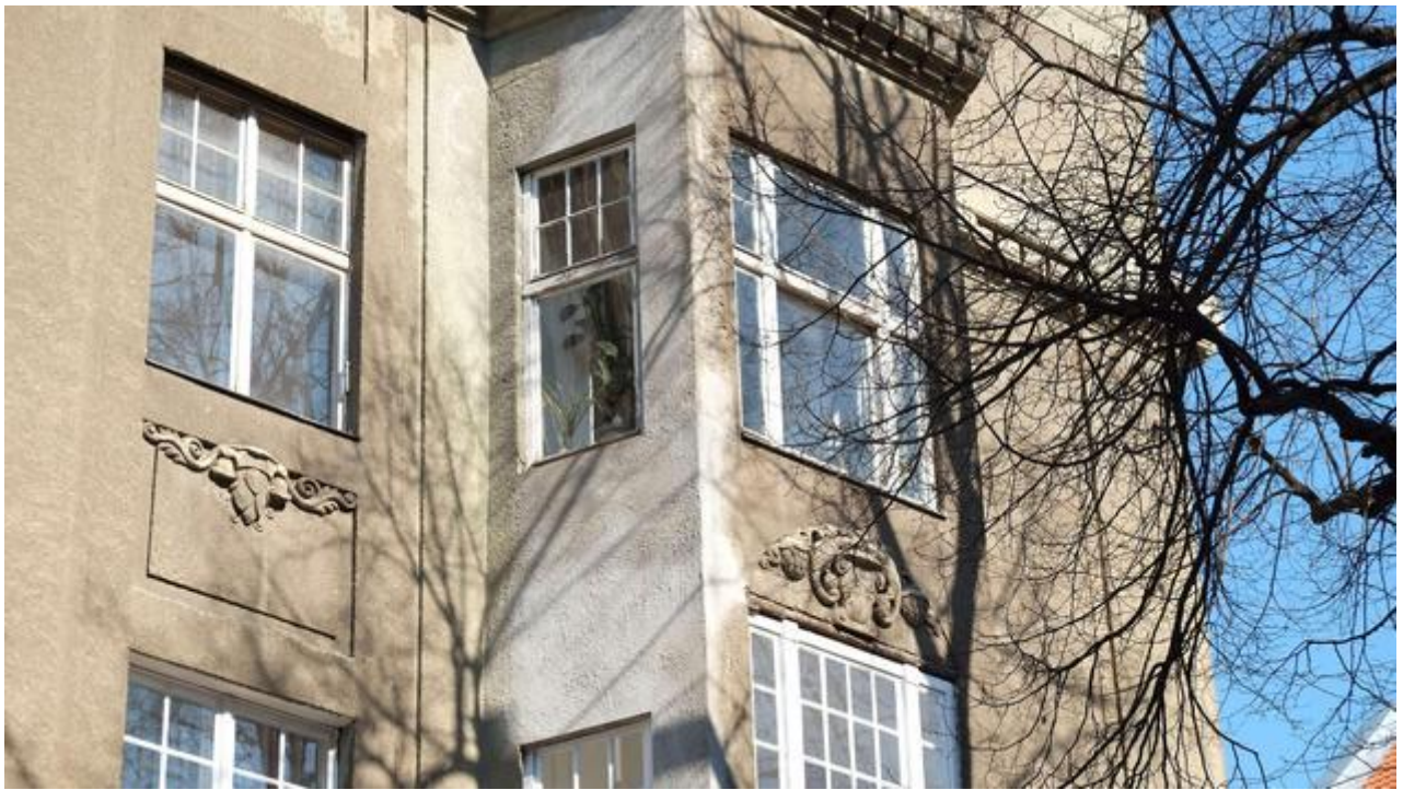
Streitobjekt: Die Fassade des Hauses in der Kavaliertstraße 19. - Foto: Ulrike Scheffer
